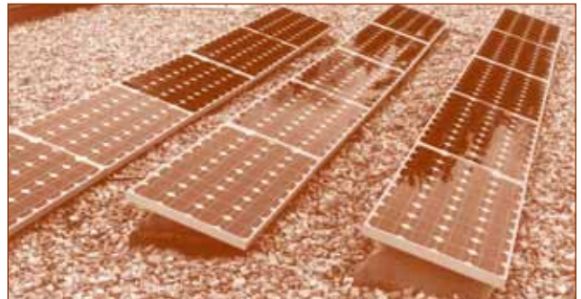
PV-systeem op betonnen prefab voet op plat dak te Mechelen (Solar Technics)
